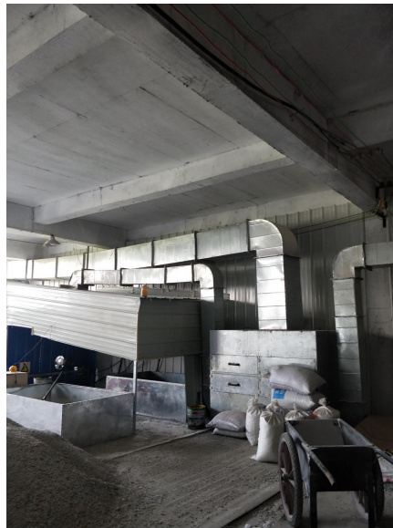
二级活性炭处理装置
