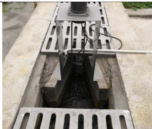
废水出口巴式槽
