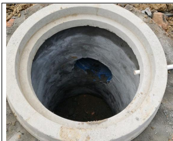
厂区雨水管网
