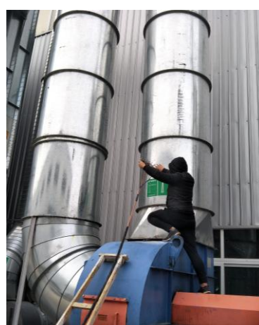
1 号布袋除尘器出口
