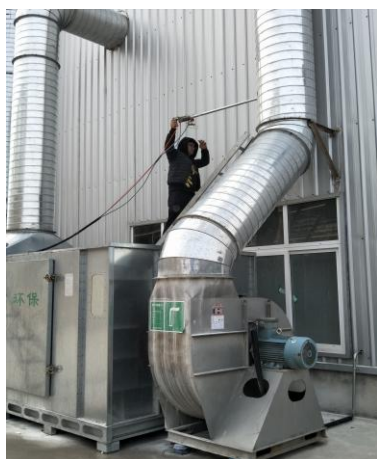
6 号活性炭吸附装置出口
