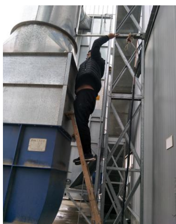
2 号中央除尘器出口
