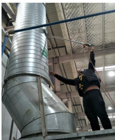
7 号活性炭吸附装置出口
