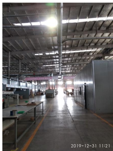
加工粉尘管道收集装置
