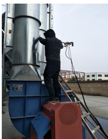
1 号活性炭吸附装置出口
