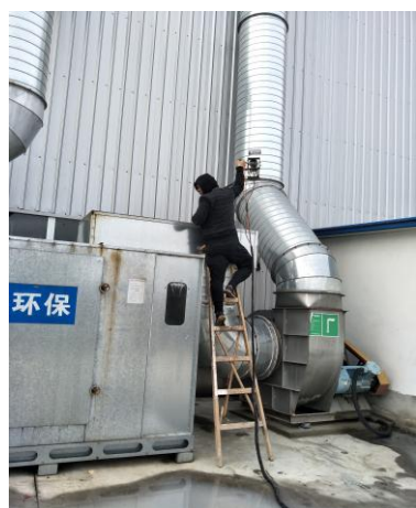
3 号活性炭吸附装置出口
