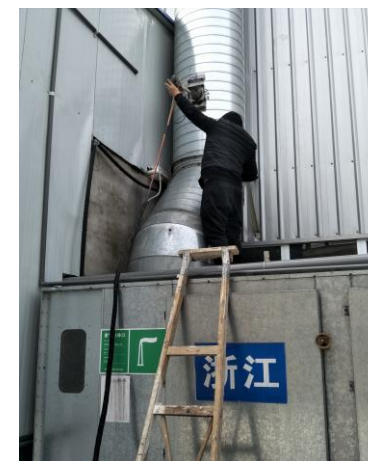
5 号活性炭吸附装置出口
