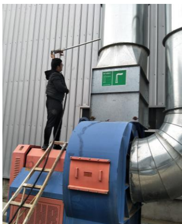
1 号中央除尘器出口
