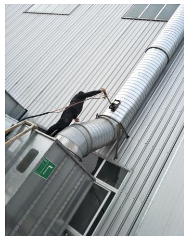
4 号活性炭吸附装置出口
