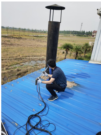
锅炉排气筒出口
