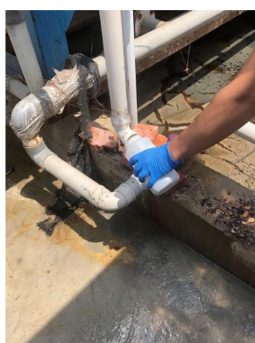
污水处理站出口
