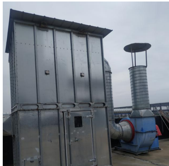
UV 生产线除尘设施
