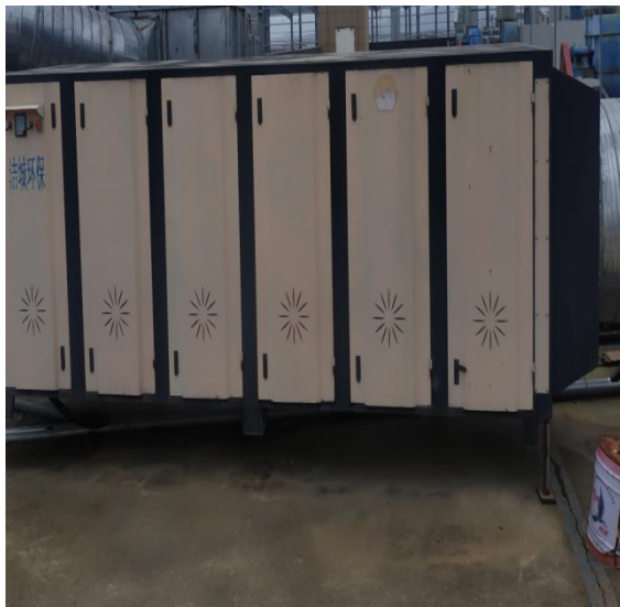
刷胶废气处理设施
