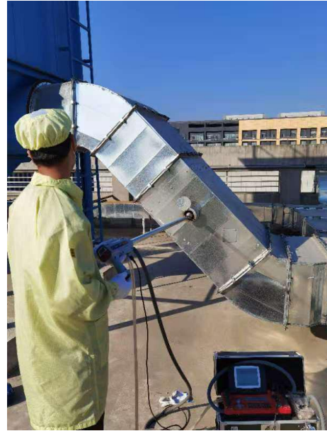
废气处理设施进口
