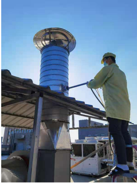
废气处理设施出口
