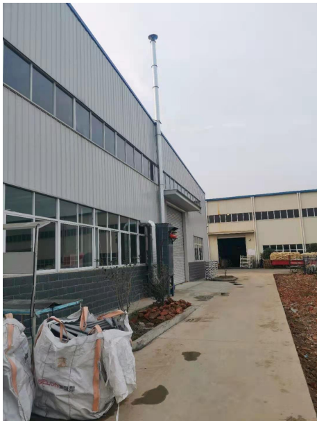
布袋除尘器+排气筒
