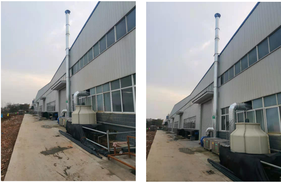
二级活性炭+排气筒
