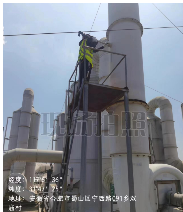
G22 4#厂房酸性废气处理设施①进口
