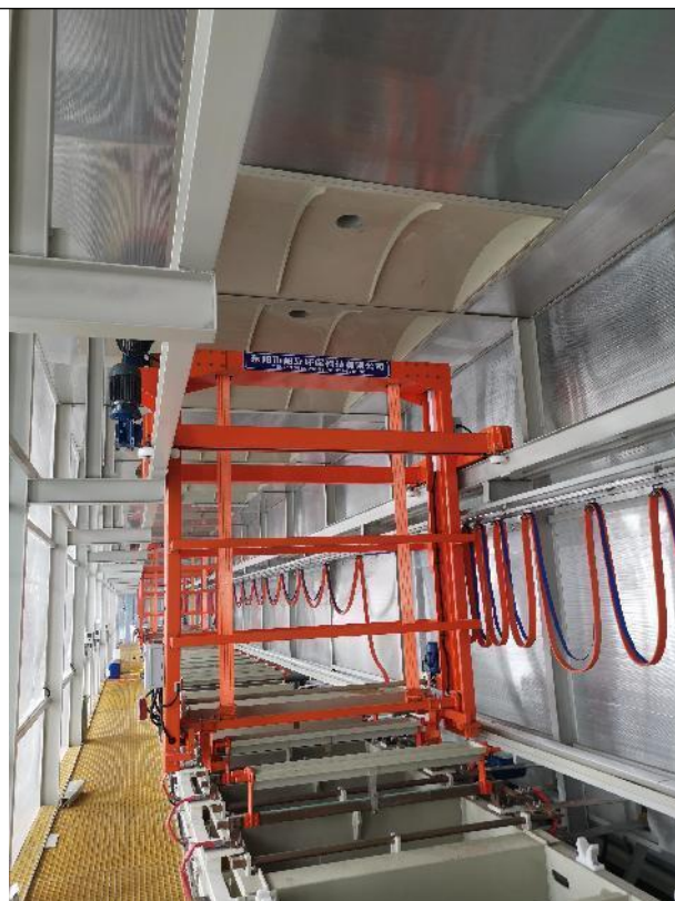
电镀线侧吸废气收集
