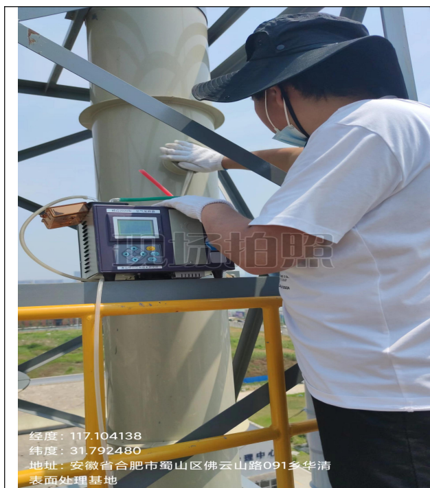
G21 4#厂房氰化氢废气处理设施出口
