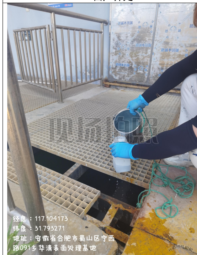
W1 含镍废水收集池
