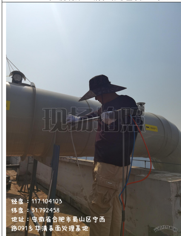
G23 4#厂房酸性废气处理设施②进口
