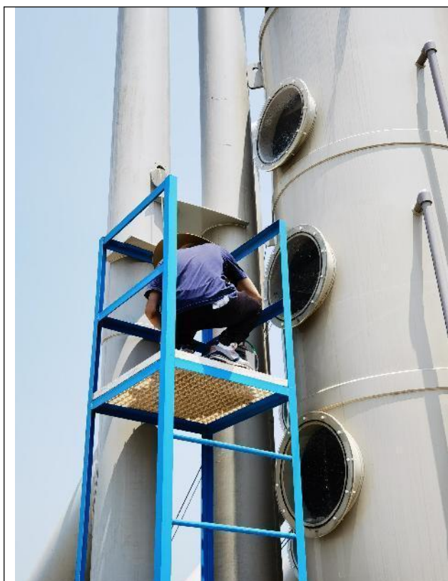
G9 9#厂房氰化氢废气处理设施出口
