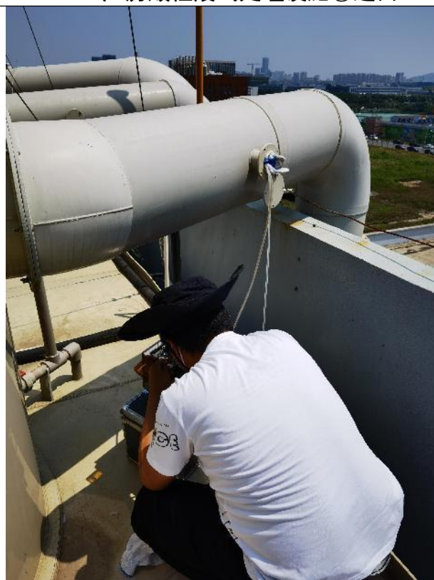
G8 9#厂房氰化氢废气处理设施进口
