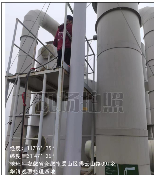
G5 9#厂房酸性废气处理设施①进口
