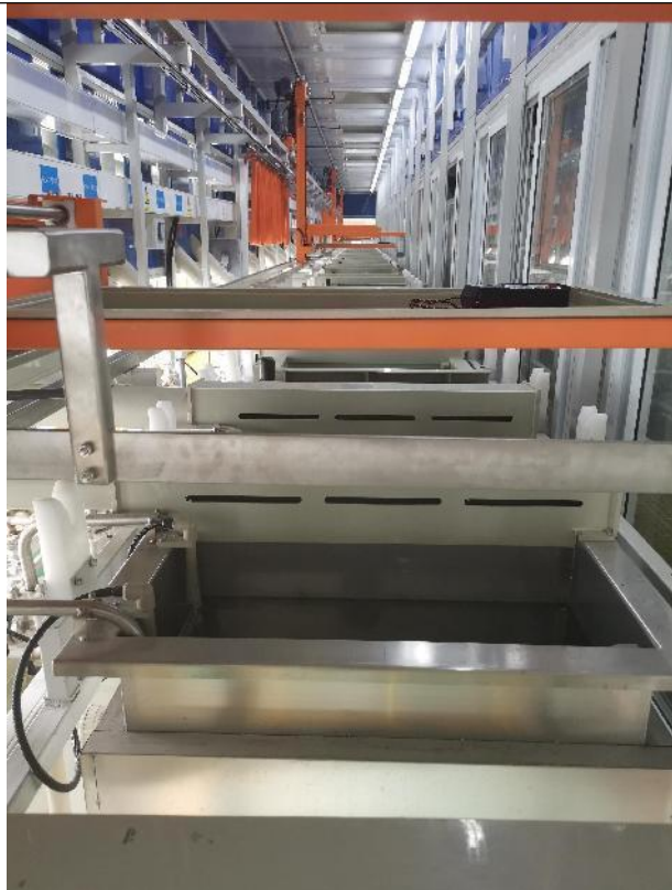
电镀线顶吸废气收集
