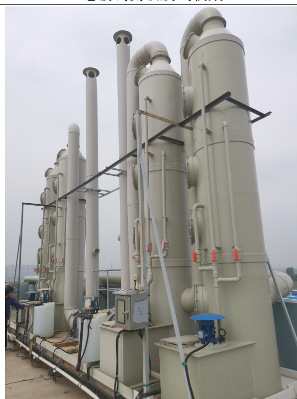
7#厂房酸性废气处理设施
