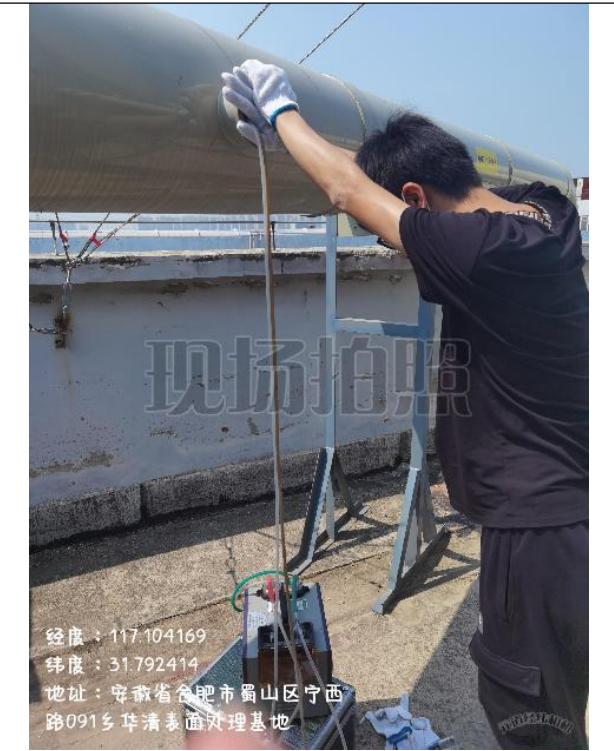
G20 4#厂房氰化氢废气处理设施进口
