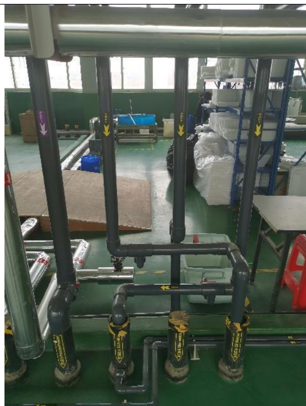
电镀线废水收集管线
