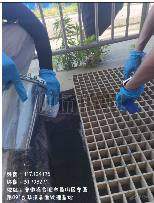
W5 总铜废水收集池
