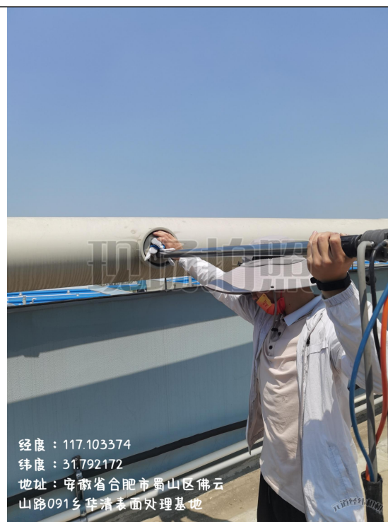
G14 斯特凯投料粉尘废气处理设施进口
